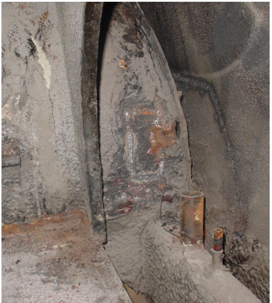
Hier kijken wij in de kofferbak tegen de rechter, achterste wielkast aan. Boven de verticale pijp is oud laswerk te zien en rechts ervan zelfs een gat. Was pas zichtbaar na het wegkrabben van een paar centimeter tectyl.
