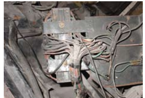
De zekeringenkast bevindt zich in het motorcompartiment (hier is de onderzijde zichtbaar). Vooralsnog wordt de bedrading niet losgemaakt gezien de wir-war. Tijdens het spuiten zal de kast worden ingepakt.
